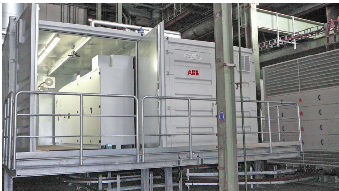
Die wassergekühlten ACS 1000 Mittelspannungs-Frequenzumrichter wurden anschlussfertig in vollklimatisierten Spezial-Containern untergebracht.
