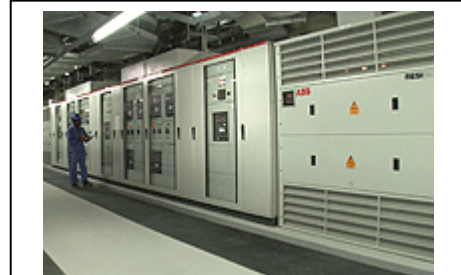
ABB の低電圧配電盤と変圧器が、アラブ首長国連邦ドバイにある世界一の超高層ビル、ブルジュ・カリファへ電力を供給しています
