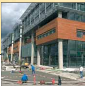
Nytt BI-bygg med ABB utstyr side 7
