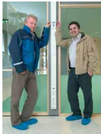
YIT Building System AS har utviklet en prefabrikkert grenstav sammen med Maxeta og ABB, her viser Lars Berger (t.v) fra YIT sammen med Frode Gandrud (t.h) fra ABB hvordan slutt-resultatet ble. Grenstaven er komplett levert med data, tele, sterkstrøm og EIB, hvor alt er prefabrikkert med pluggløsninger hos Maxeta i Skien.
