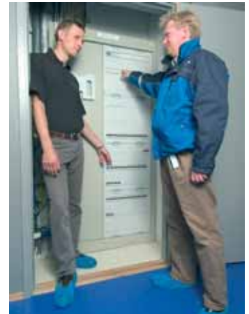
Lars Berger (t.h) fra YIT Building System AS forklarer hvordan lys kontrolleres av EIB komponentene som er levert av ABB. Geir Bothner (t.v) sier de har levert totalt over 100 slike underfordelinger.
