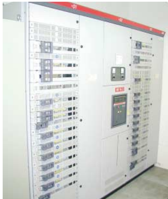
Glava-fabrikken i Stjørdal har både ABB MNS-tavler og Siemens-tavler med SlimLine.
